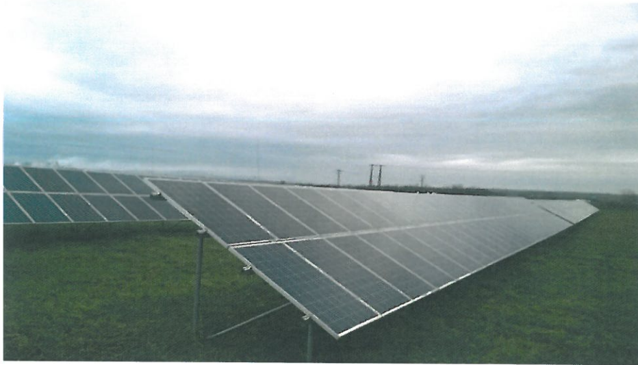
Telepített napelerőmű Peremarton – Jázmin út melletti területen 1751/32 hrsz.
